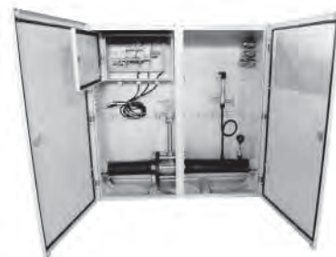
Рисунок 4. Шкаф в шкафу (ШШ)
